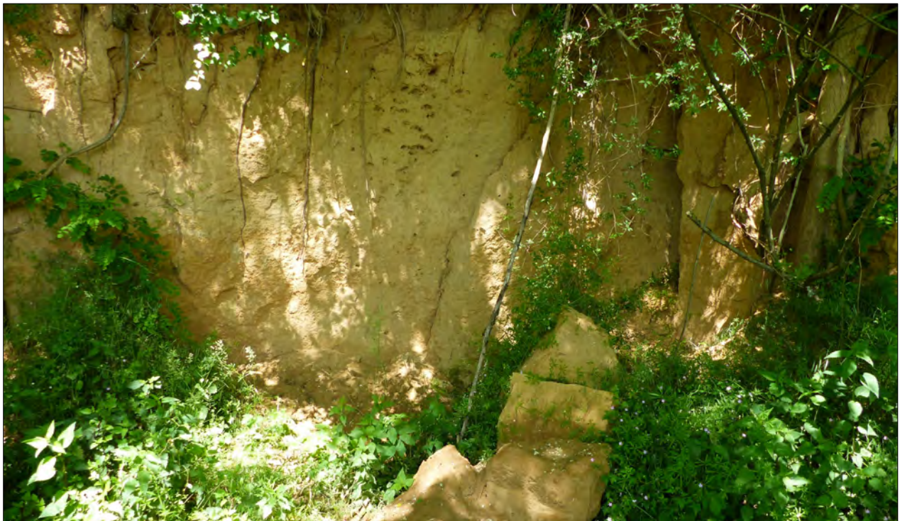
Abbildung 26: Blick auf die größtenteils zugewachsene Lehmwand östlich der Schöllkrippener Straße
